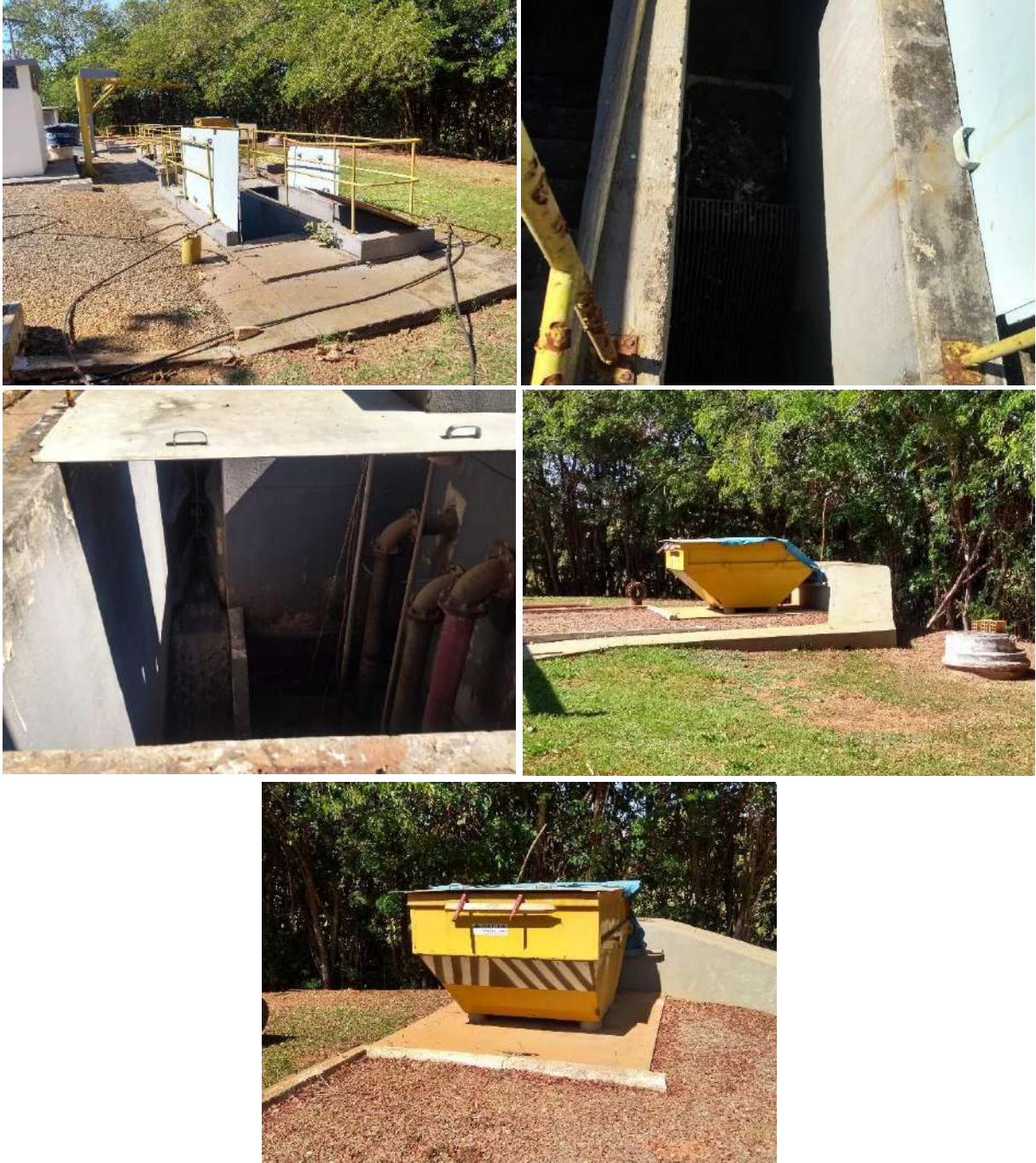
Figura 36: Gradeamento, calha Parshall a montante da ETE e coletor de resíduos do gradeamento
