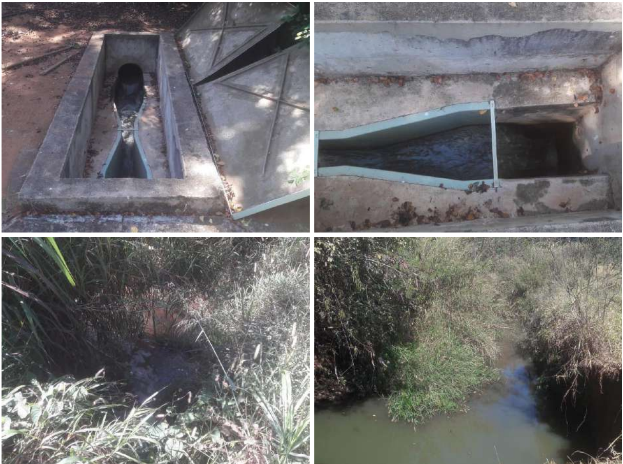
Figura 41: Calha Parshall e Despejo no Curso Hídrico
