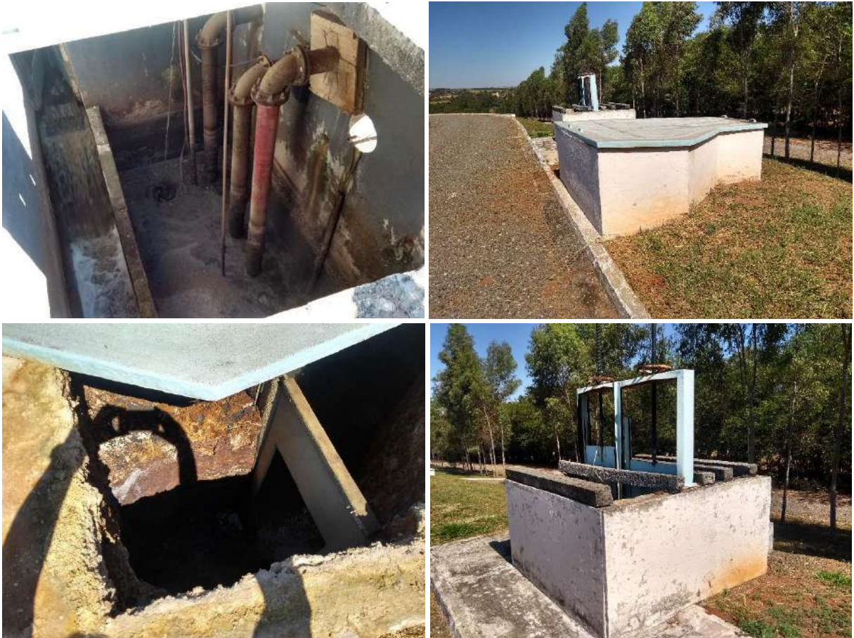
Figura 37: Estação elevatória de esgoto e receptor do esgoto bruto
