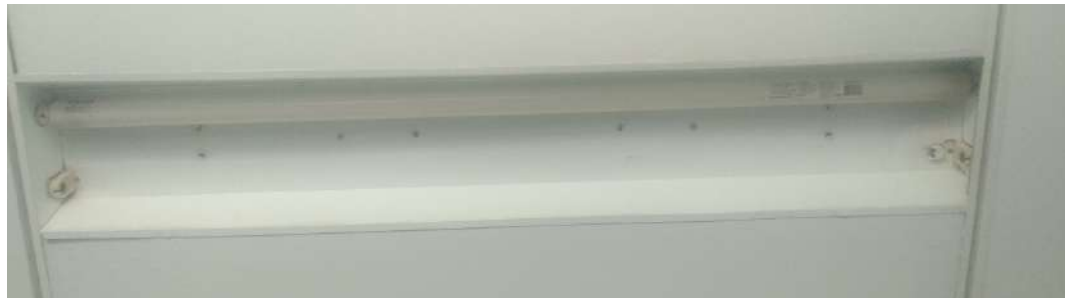
Figura 4 Luminária tipo calha 2x18w
