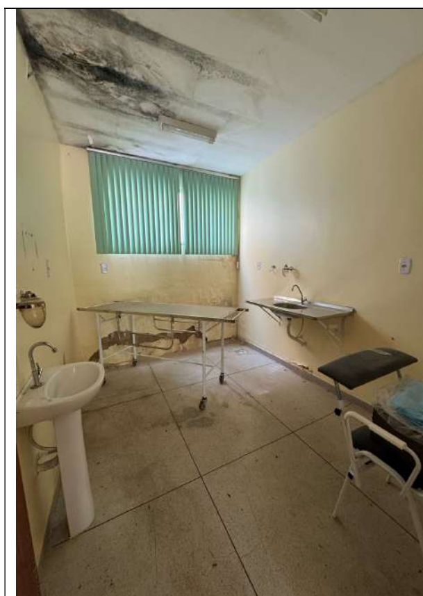
Sala de vacinas
