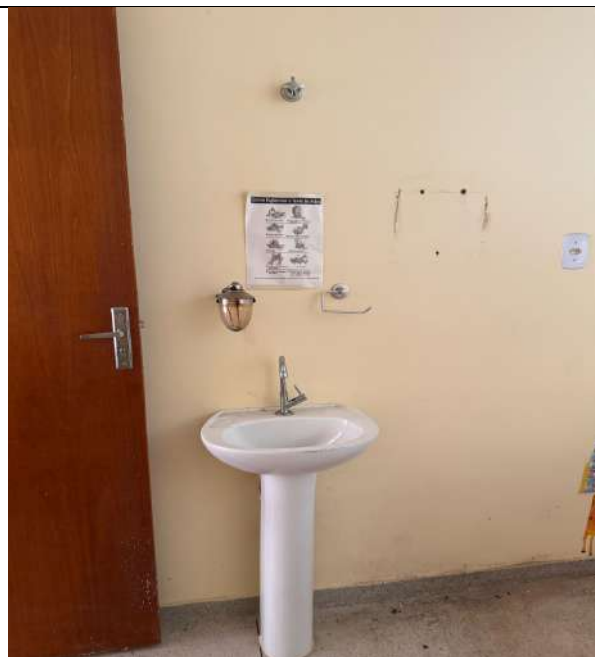
Lavatório com coluna da sala de vacinas
