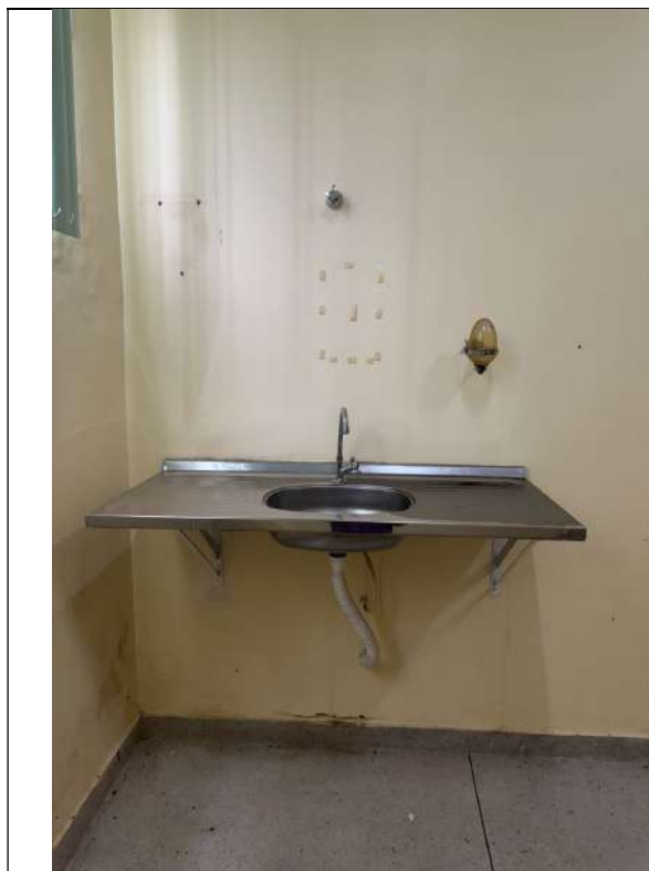
Pia inox da Sala de Observação / Procedimento / Coleta
