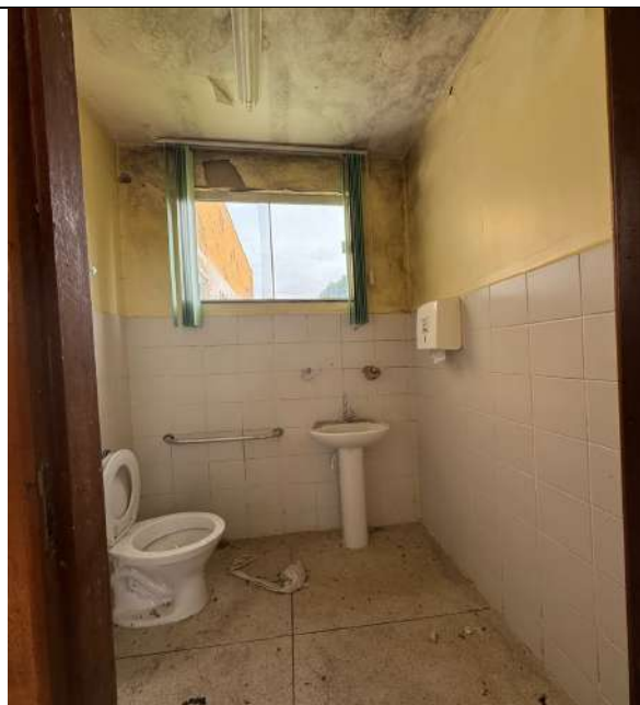
Sanitário PCD Masculino
