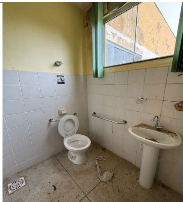
Sanitário PCD Masculino
