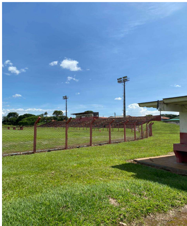
Figura 2 – Arquibancada (guarda-corpo de perímetro)
